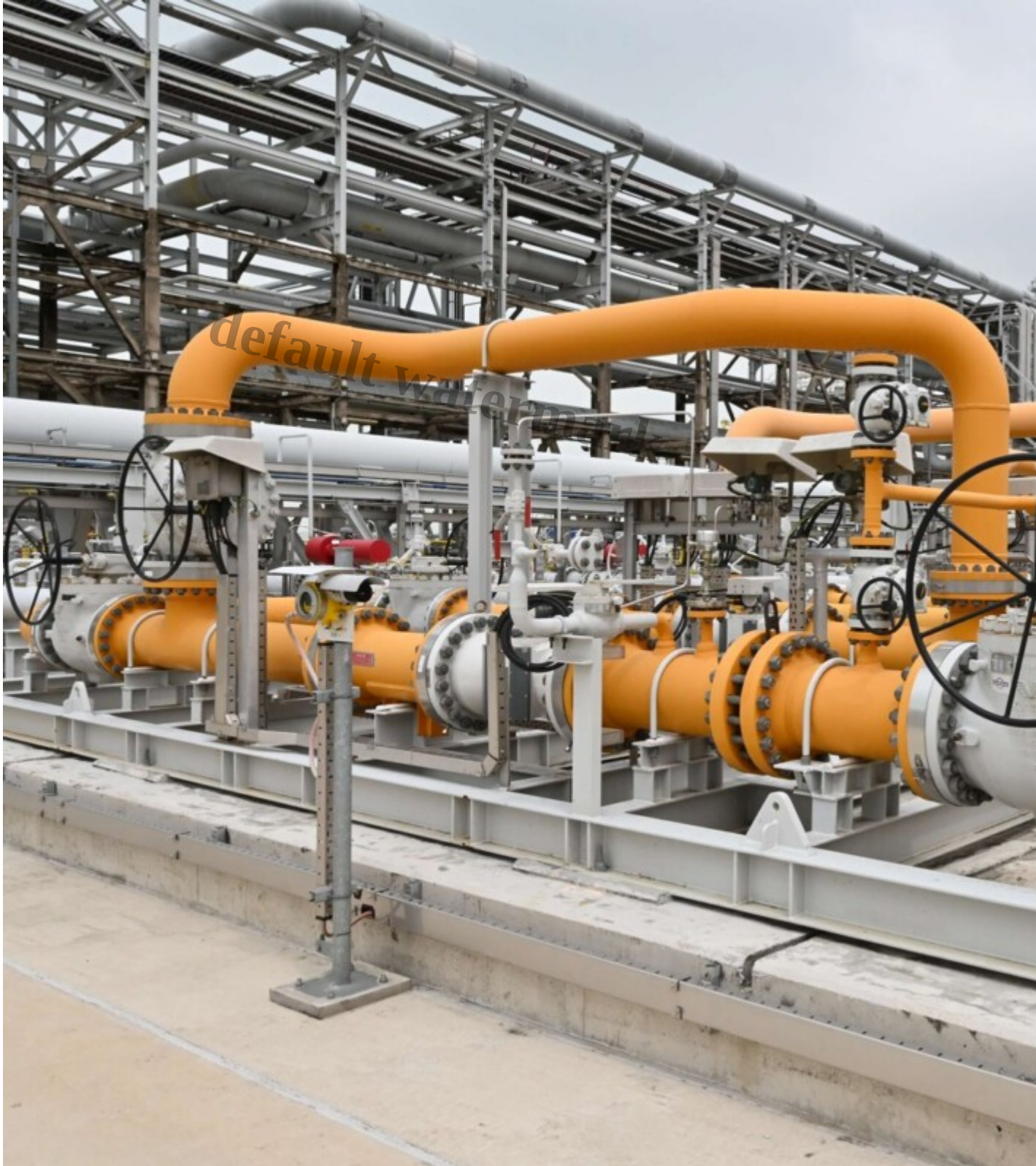
Pipework at the LNG terminal. Photo: SLNG
